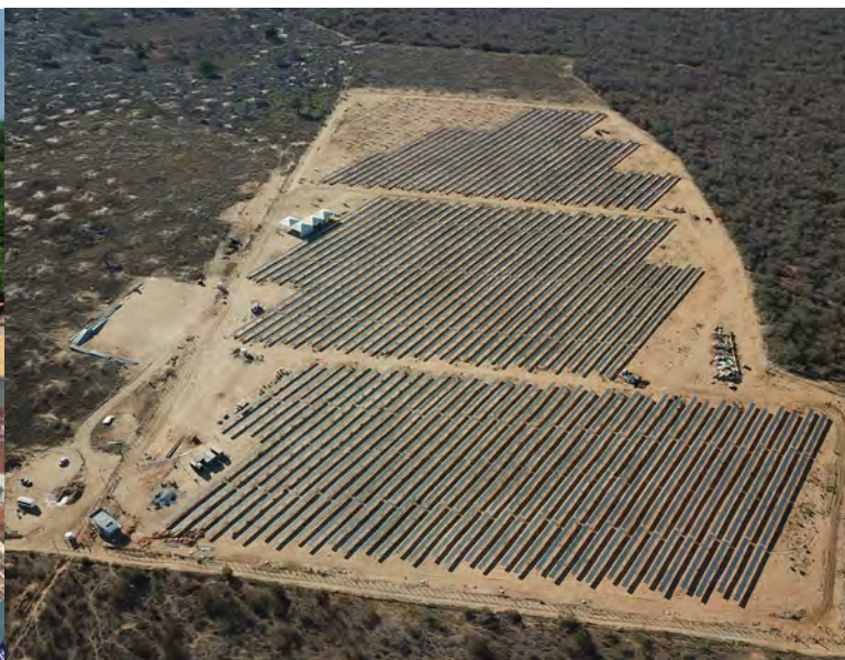
Usina Fotovoltaica (UFV) da Oi em Jaíba (MG)
