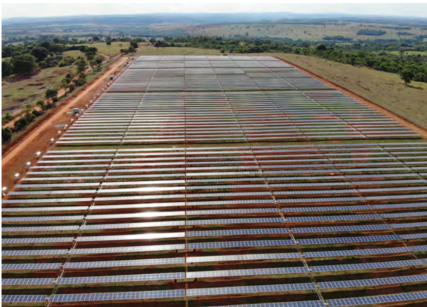
Usina solar da Vivo instalada na área rural de Paranoá (DF)
